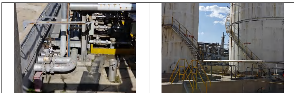
图 5.2-4 企业管道运输现场照片
