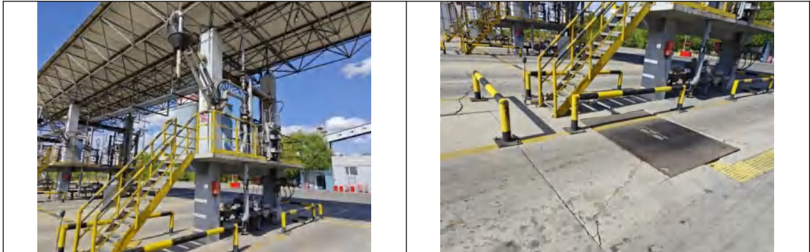
图 5.2-3 液体物料装卸平台现场照片
